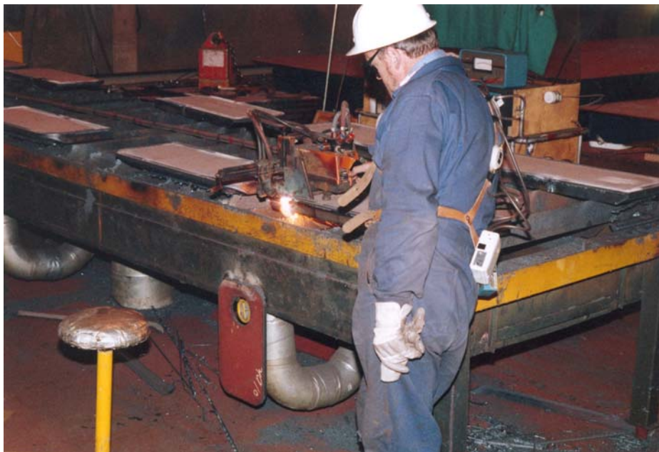
Fig. 9.7 Halvmaskinel flammeskæring på fast arbejdsplads. Indrettet som skærebord med udsugning under plade.
