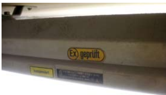
Billede viser et ældre eksplosionssikret lysarmatur
