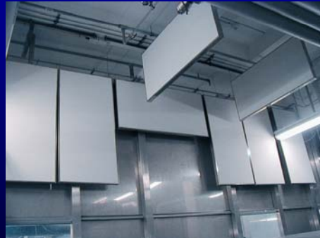
Åbning over væg akustisk dæmpet ved hjælp af nedhængte absorbenter
