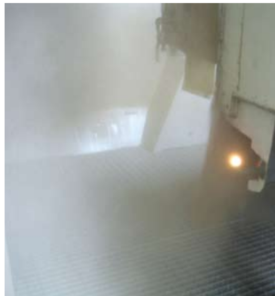
Under losning støver det inde i lastvognspåslaget. Det vurderes dog, at mængden af støv normalt er under den nedre eksplosionsgrænse.
