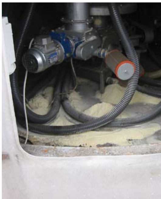
I rummet under siloerne er der installeret elektrisk materiel. Der ligger små mængder mel på gulvet i rummet, der dog ikke vurderes at kunne give anledning til eksplosiv atmosfære.
