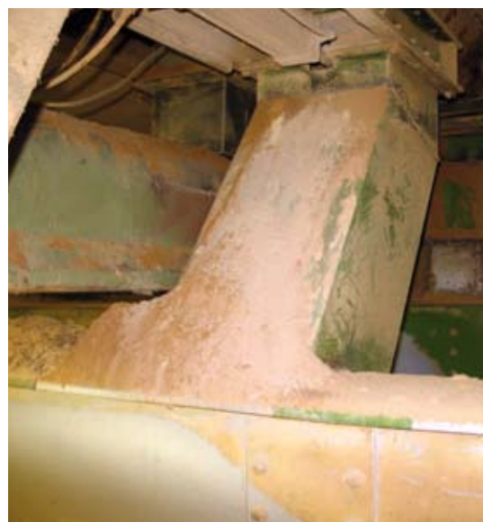
Det aflejrede støvlag består af meget fint støv. En evt. eksplosion i rummet kan derfor give anledning til ophvirvling af støvet og dermed starte en sekundær eksplosion.
