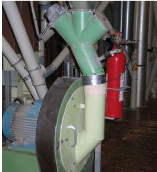
Gnistdetektion og slukning med vand eller CO 2 er en mulig løsning, hvis I ikke kan undgå tændkilder (her gnister) i et anlæg. Billedet viser en CO 2 -slukker på en mølle.
