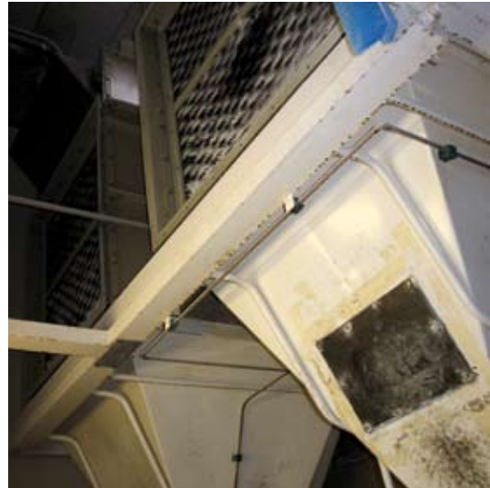
Eksplodingsaflastninger på filteranlægget er ikke ført ud i det fri.
