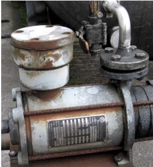
Ældre Ex-mærket udstyr (pumpe) til sprit.
