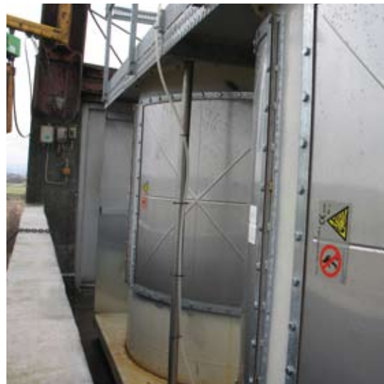
Eksplodingsaflastninger udendørs på toppen af nye siloer.
